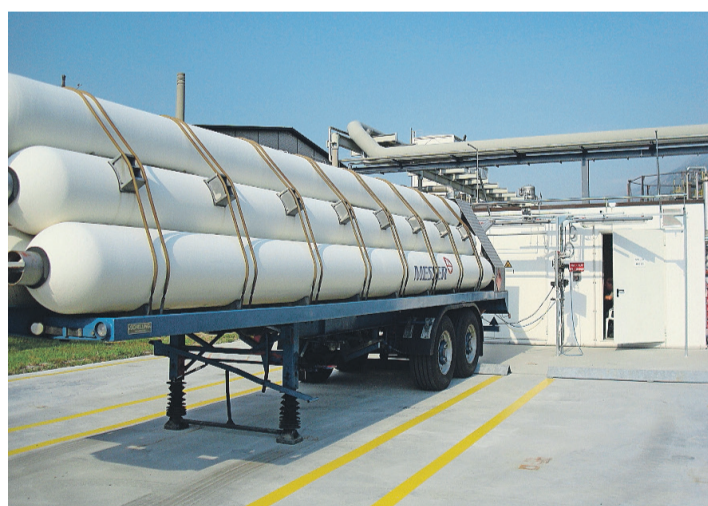
Gehört ebenfalls Messer: Verdichterstation für Wasserstoff. Bild: zvg
