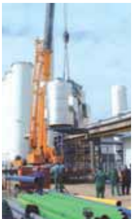
Ein neuer Stickstoff-Generator wurde planmäßig auf dem Gelände des größten Chemieproduzenten Ungarns, TVK, durch Messer Hungarogáz installiert.
