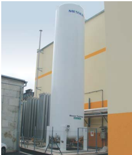
Die Partnerschaft zwischen dem Kunden Spolchemie und Messer Technogas begann bereits 2001 mit der Installation einer On-Site Produktionsanlage für Stickstoff.
