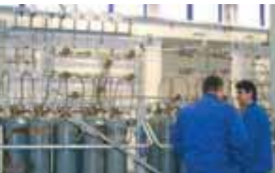
Eine neue Abfüllanlage für Gasgemische und Argon konnte bei Messer Croatia Plin in Betrieb genommen werden und sorgte für Umsatzwachstum in 2004.
