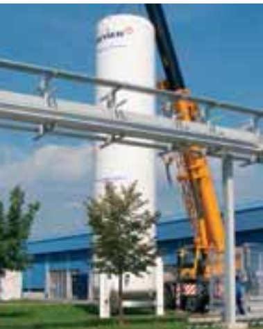
Bei dem führenden slowenischen Pharmazieunternehmen Lek wurde eine zentrale Gasversorgung für Luftgase und für Spezialgase installiert.
