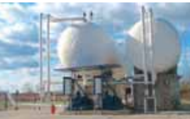
Durch die Inbetriebnahme einer weiteren Anlage zur Herstellung von Kohlendioxid wurden die Kapazitäten in Kroatien ausgebaut.
